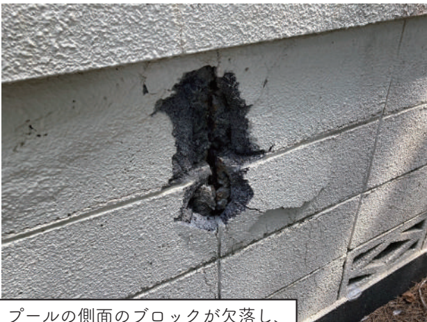
プールの側面のブロックが欠落し、中の鉄筋が見えている
